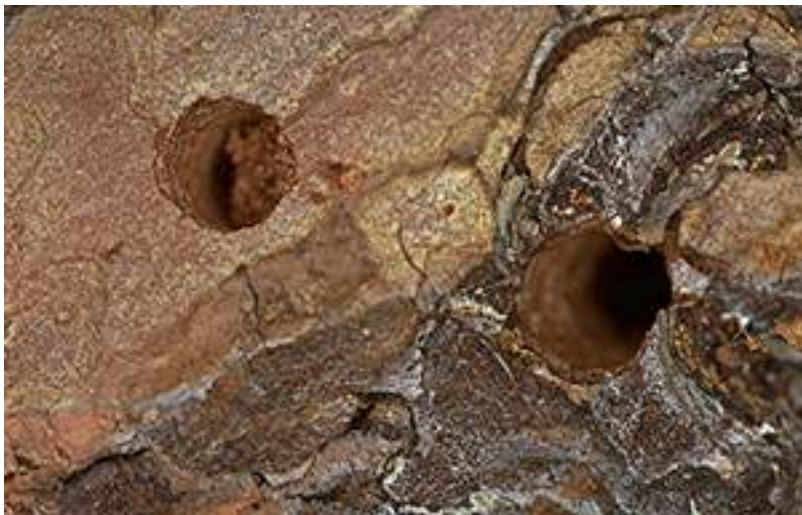
Typische, kreisrunde Ausbohrlöcher der ausgeflogenen Holzwespen
