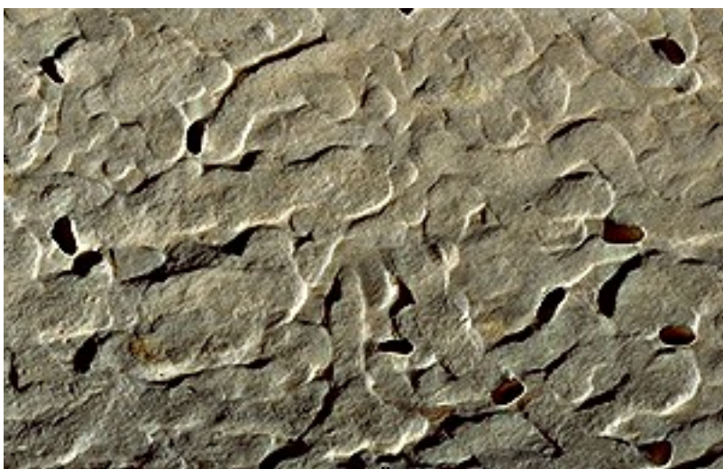
Sich überkreuzende Frassgänge mit den Öffnungen der Hakengänge ins Holz.
